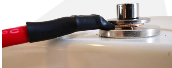
Figure 4. FAUX! Connexion desserrée en raison de l'utilisation d'un boulon trop long
